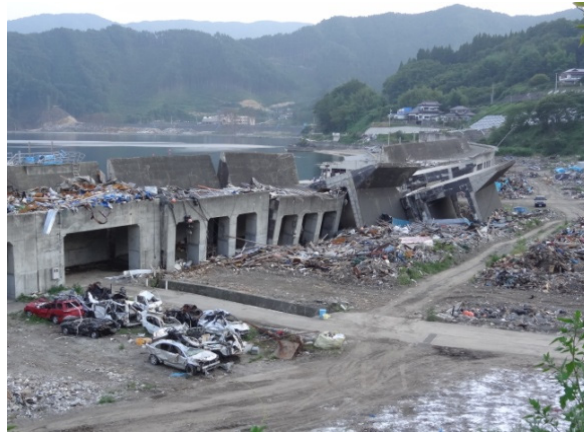
写真-1 津波により倒壊した防潮堤
