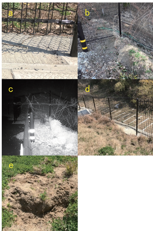
図7 伊都キャンパスIV工区における獣害発生および補修必要箇所
