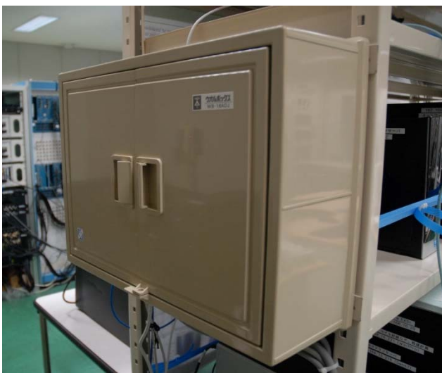
図 5 サーバー用分電盤
