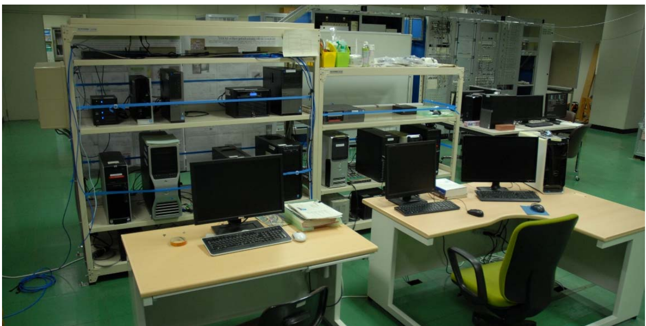
図 7 サーバーラック全体と監視用デスク
