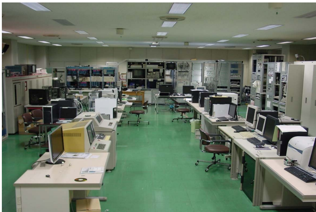
図2 制御室東側（制御室中央から東向きに撮影）
