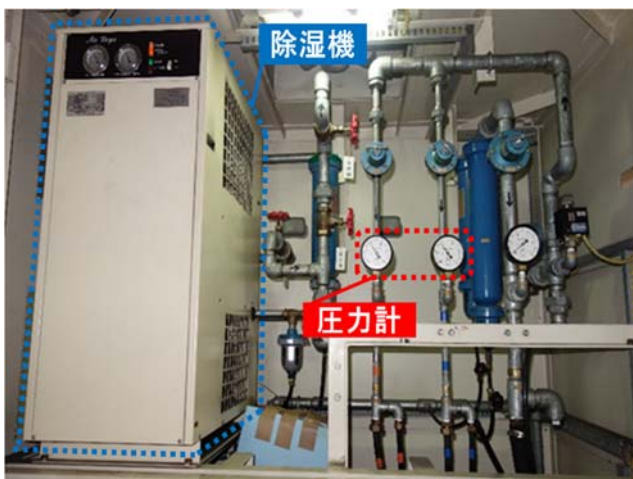
図4 加圧除湿器盤上部
