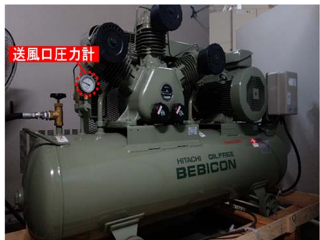
図5 コンプレッサー
