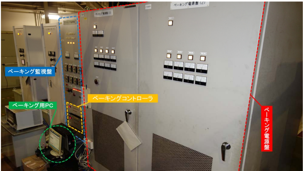
図2 電源盤・監視盤・PC
