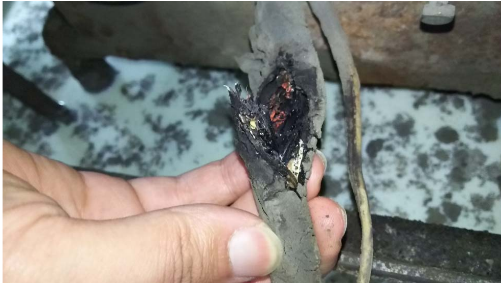
図5 断線したケーブル
