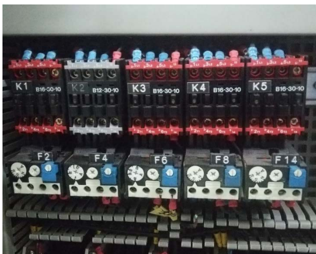
図3 サーマルリレー設置箇所
