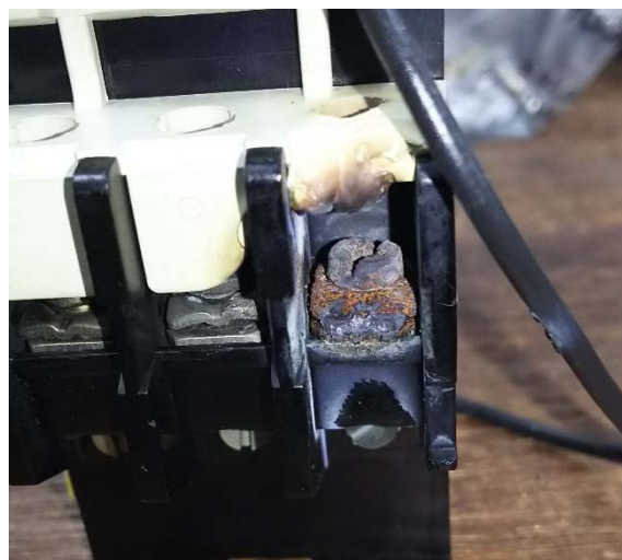
図4 破断した端子部
