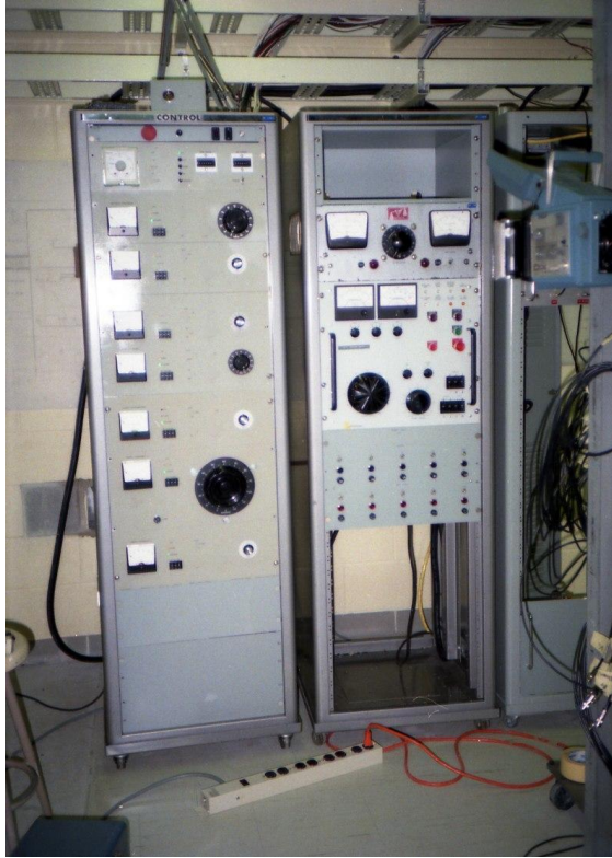
図 18. 充放電制御装置
