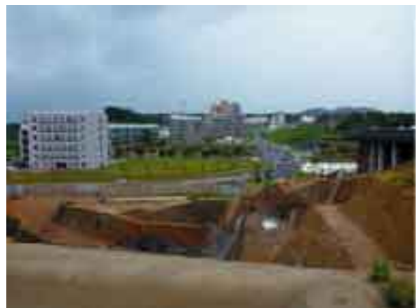
掘削工事が進む中央図書館工事現場から見たセンターゾーン および椎木講堂。
