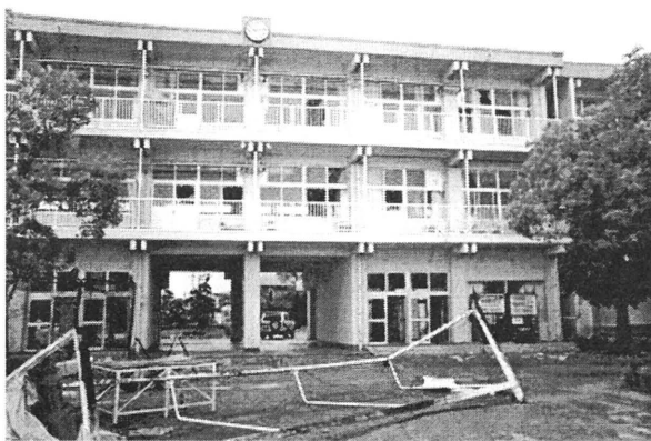
写真 11-④ 校舎南側面の被害
