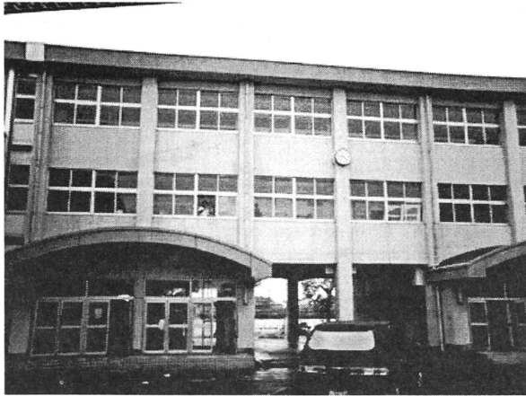
写真 11-③ 校舎北側面の被害
