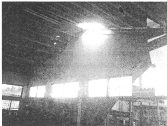
写真 11-⑪ 柔剣道場屋根の破損（内部から）
