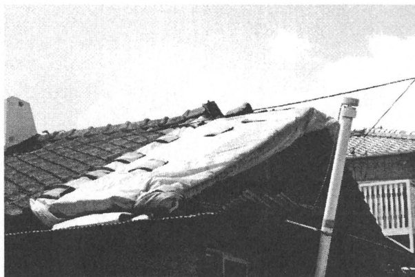
写真 13 住家 瓦屋根の破損
