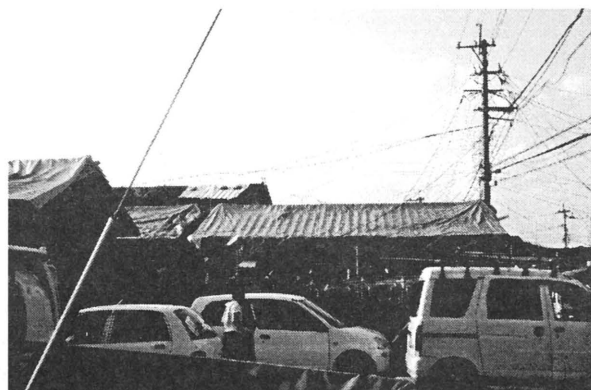
写真2 住宅屋根の破損
