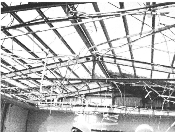
写真 7 農協施設 2 階屋根の破損
