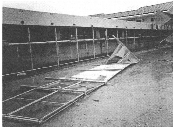
写真 11-⑬ プールフェンス破損
