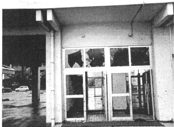
写真 11-⑥ 昇降口入り口扉の被害
