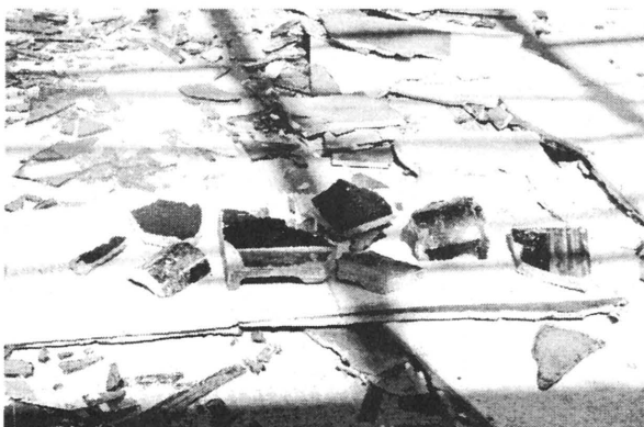
写真 8 室内に残された飛散物
