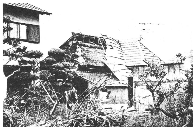
写真4 屋根拭き材の飛散
