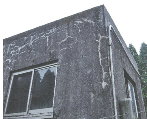
写真6 外壁の変状 (E-1)
