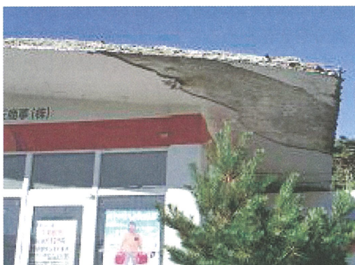
写真4 屋根スラブ軒先の変状 (F-1)
