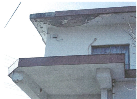
写真8 仕上げの剥落 (D-5)
