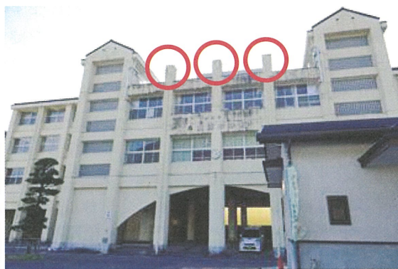
写真5 柱頂部の変状 (C-1)
