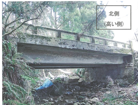
写真7 橋梁の変状 (A-2)
