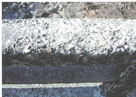
写真1 スケーリング (F-2)
