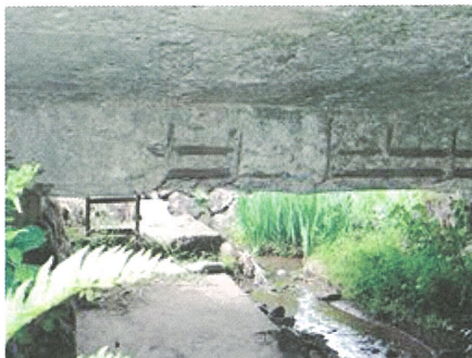
写真2 鉄筋露出 (C-5)
