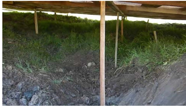
図 6.10 地表沈下状況
