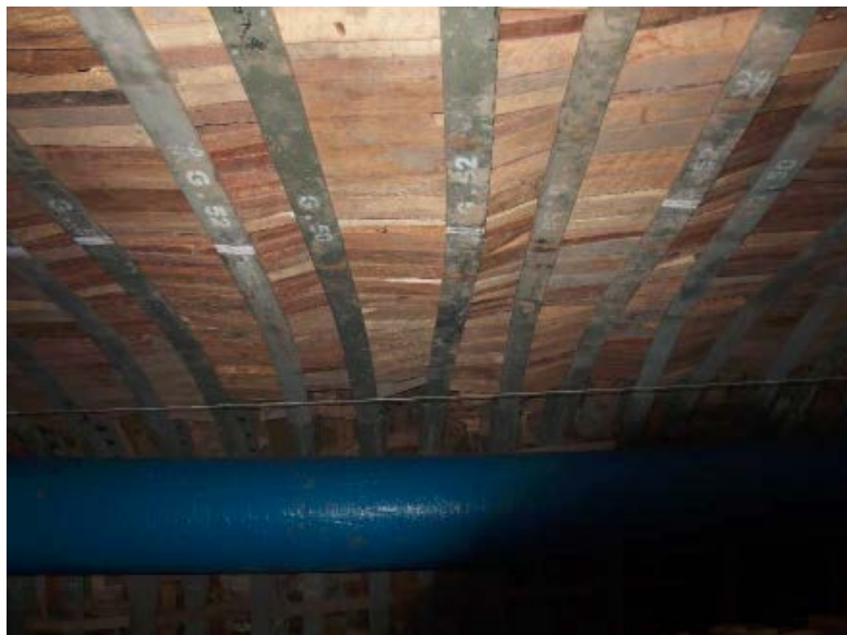
図 6.2 梁部変形状況
