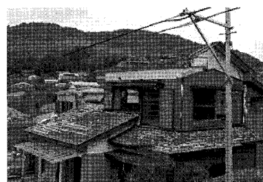
(a) 全体被害の一例
