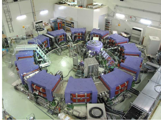
図 57-3 設置された FFAG 加速器（交互勾配固定磁場型シンクロトロン）
