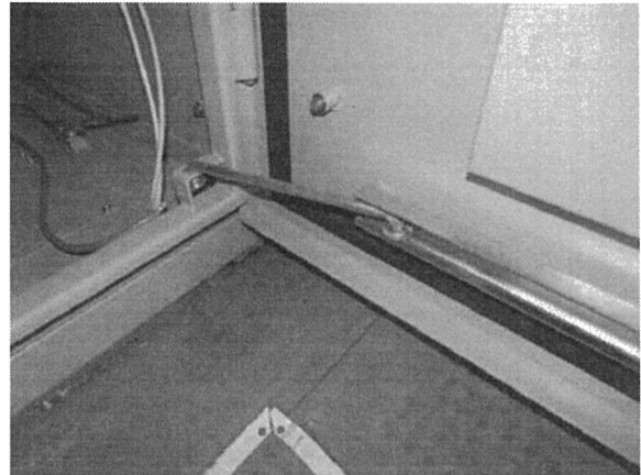
図6 制御盤扉ロック
