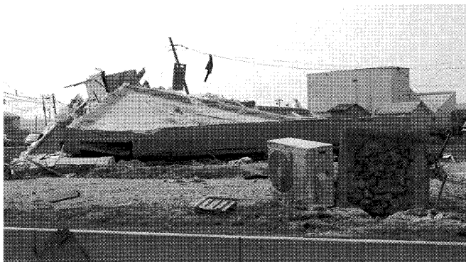
写真1 竜巻によってべた基礎ごと転倒した住宅 (2012年 つくば市)
