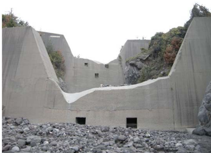
写真 3.5-1 砂防堰堤における摩耗事例
