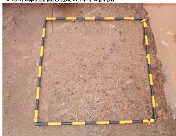
(摩耗状況；H19.9.25)
