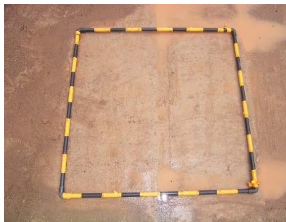
(摩耗状況；H19.9.25)
