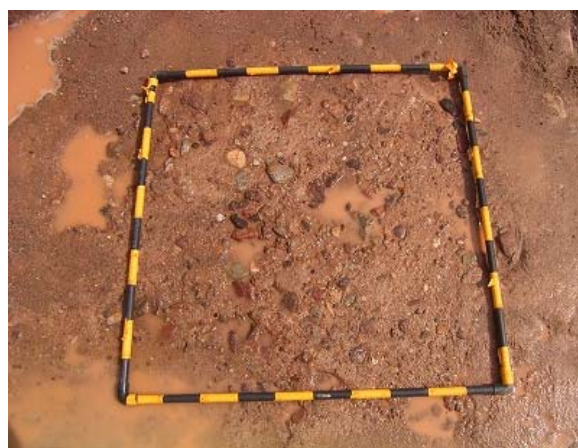
（摩耗状況；H19.9.25）
