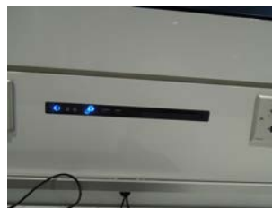
本体は隠し、端子のみ露出させている
