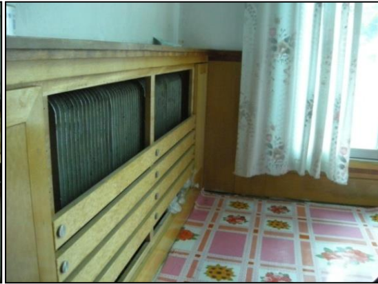
写真 11-8 カンの傍にあるラジエーター
