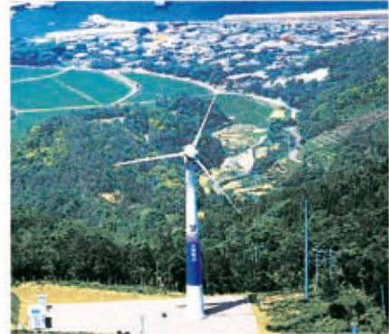
(c)C風力発電所
