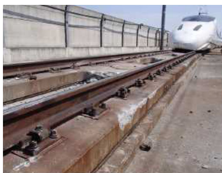
図 1-4 熊本地震で脱線した新幹線車両と軌道損傷状況 1-7)
