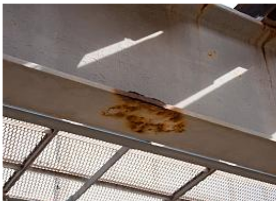
塗膜下腐食による塗膜膨れ箇所
