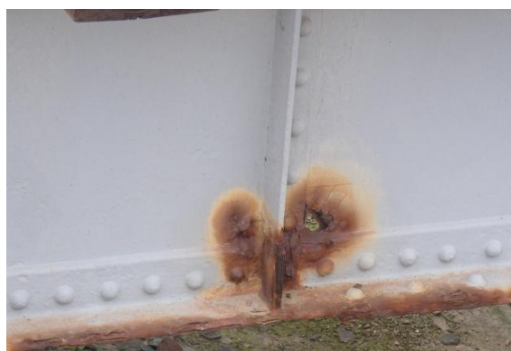
塗膜下腐食の進行により 部材が欠損した箇所
