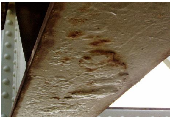
塗膜下腐食による塗膜膨れ箇所
