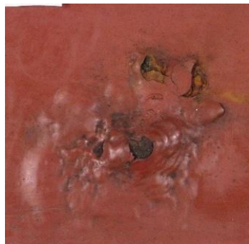
試験体①における 変状箇所の外観
