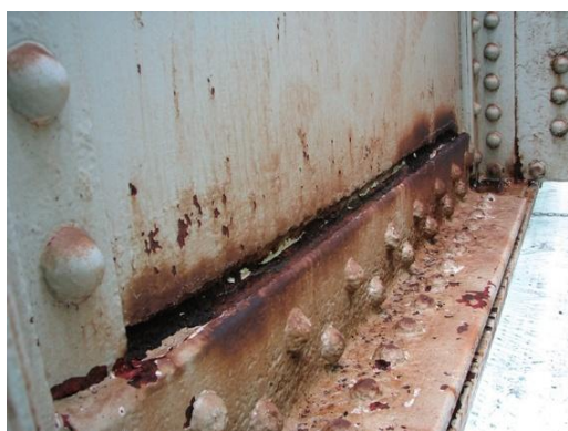
塗膜下腐食の進行により 部材が破断した箇所
