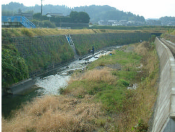
写真3 土砂の堆積した例
