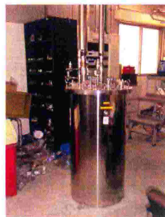
図 3 : ガス温度調整用バッファ装置
